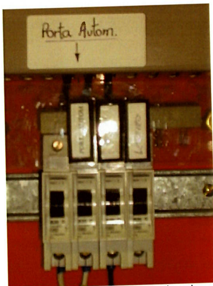
Fig. 33 – disjuntor da porta automática de enrolar
