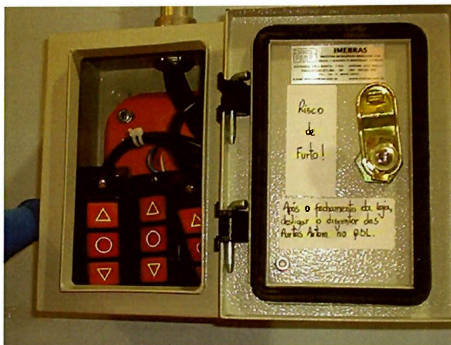
Fig. 29 – vista do quadro aberto
