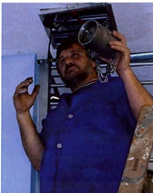
Fig. 18 – Sr. Júlio, técnico da empresa Marcenaria SP – Contratação emergencial devido à quebra de engrenagens
